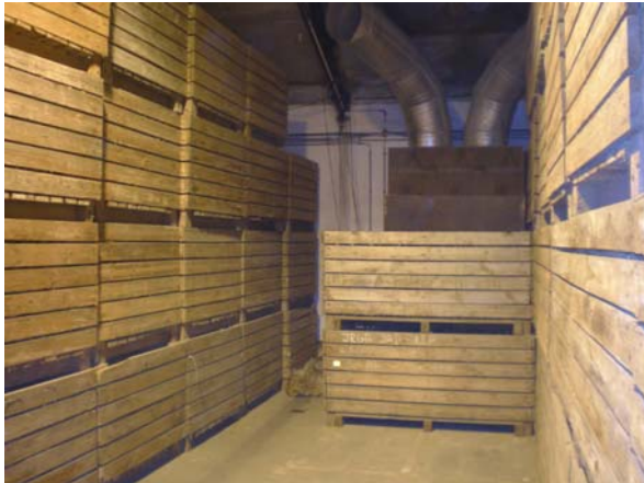
Fot. 2. Zespół wentylacyjny z rurami tłoczącymi powietrze nad palety skrzyniowe – przechowalnia IHAR w Jadwisinie
