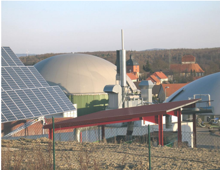
Rysunek 4. Jühnde k/Getynki - Instalacja biogazu rolniczego, fotowoltaiki oraz piec na biomasę należące do spółdzielni energetycznej (Dolna Saksonia)
